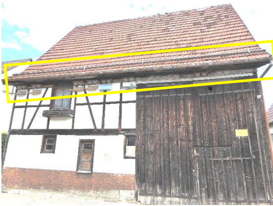
Abbildung 2: Beflogene Schwalbennester an alter Scheune (Grabenäckerstraße)
