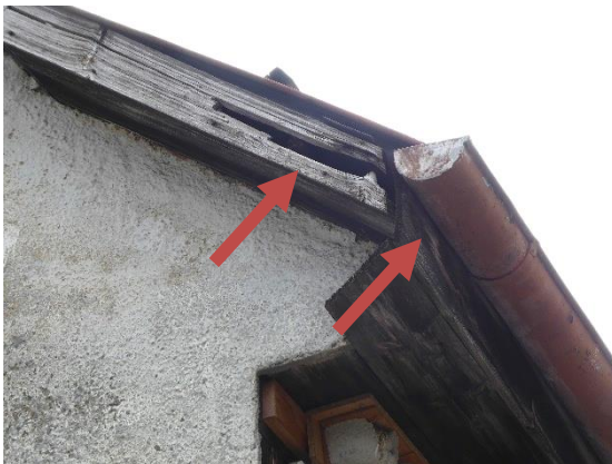
Abbildung 4: Spalten in Dachstrukturen
