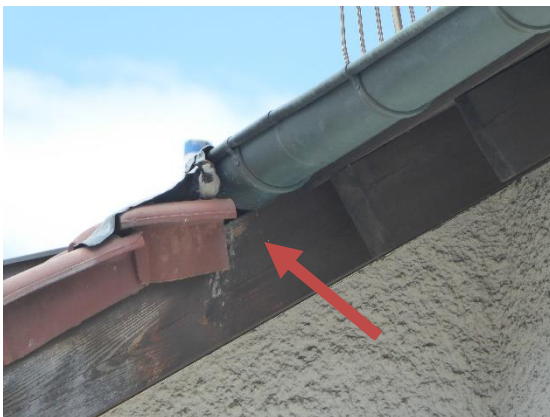
Abbildung 6: Haussperling-Nistplatz in Dachspalte
