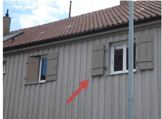
Abbildung 3: Fensterläden als potenzielles Spaltenquartier für Fledermäuse
